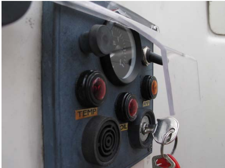
Bild 4.1 renoverad motorpanel i sittbrunnen med nya lamphållare, ny vippströmbrytare för att styra magnetiseringsströmmen. Är man osäker på hur man ska bete sig med vippströmbrytaren, lämna den som på bilden (ned) så laddar alltid generatoren.
